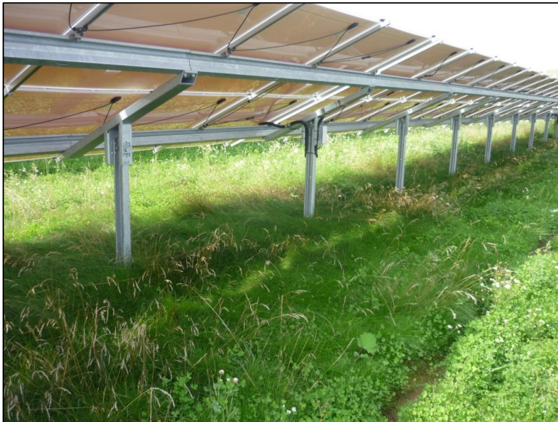
Abbildung 6: Beispiel der Aufständigung von Solarmodulen (Bereich Solarpark Ronneburg Süd).
